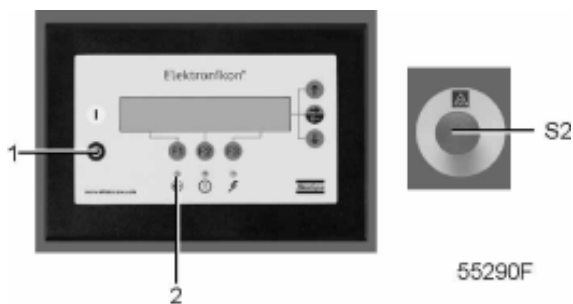
Painel de controle do ZR/ZT160 VSD
